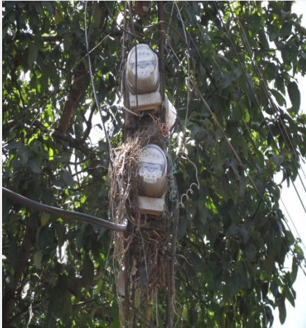
Alumbrado público inadecuado
